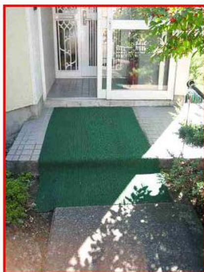
図9 通路上の段差(日本)
